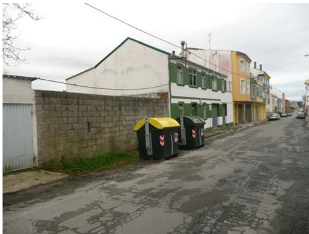
Imagen nº1. Estado del firme de la calle Monte Adairo.
