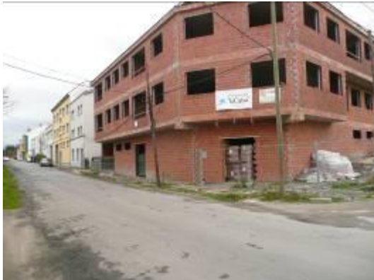
Pk: 0+240. Esquina Monte Adairo / Rúa Gaivota. Vista en dirección Venancio Senra. Edificio en construcción
