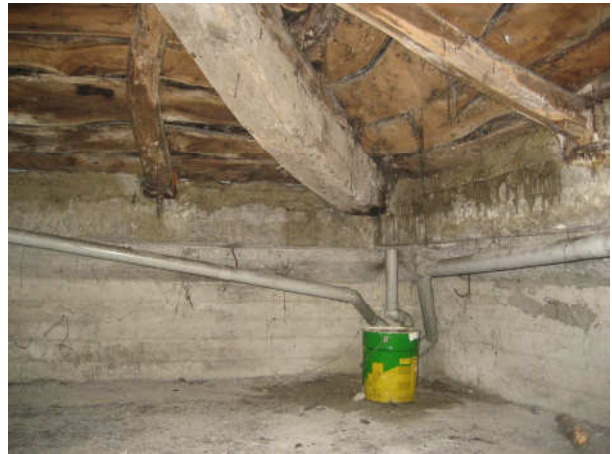
RECOGIDA PLUVIALES EN ESQUINA NOROESTE
