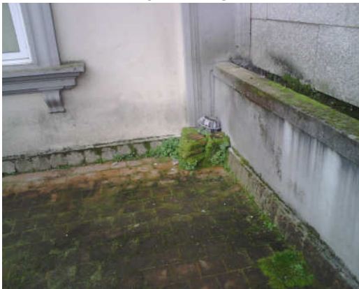
HUMEDADES EN ESQUINA OESTE
