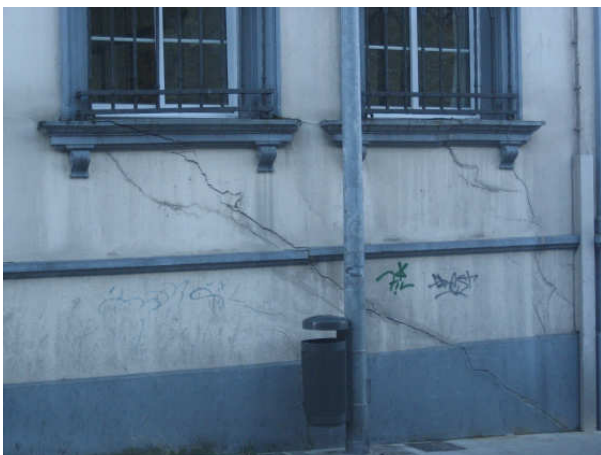
DETALLE DE GRIETAS DE FACHADA
