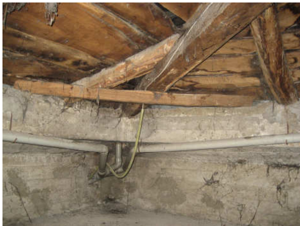
RECOGIDA PLUVIALES EN ESQUINA SUROESTE
