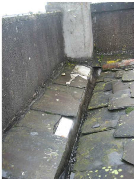
ESTADO DE CANALÓN SUR
