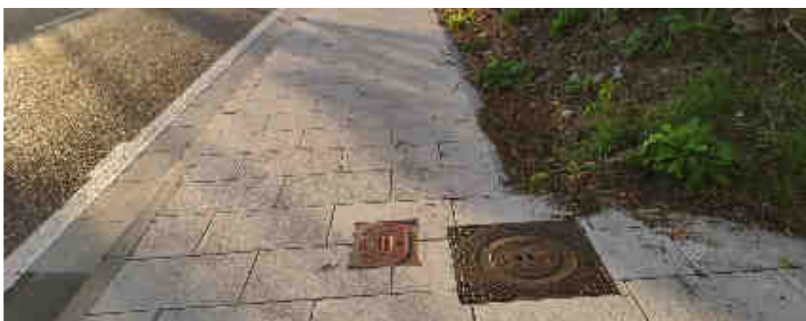
Ilustración 11 Último pozo e boca de incendios na rúa República Arxentina en sentido NO, fronte ao nº 8
