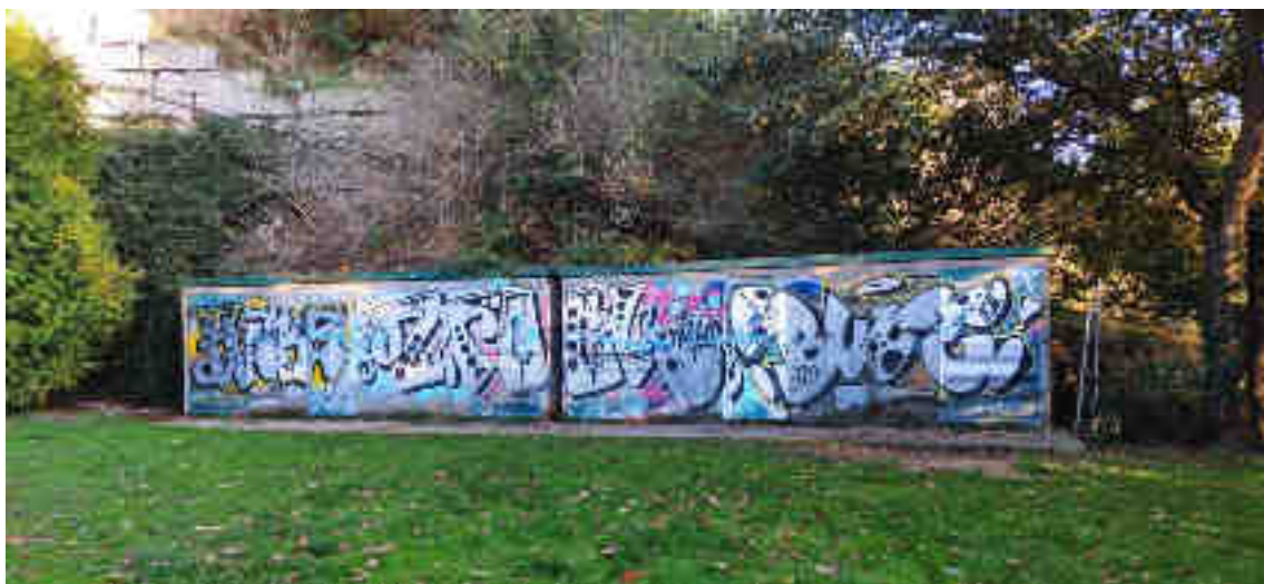
Ilustración 12 Centro de transformación de BEGASA nas costas do parque, no perímetro da parcela obxecto desta MP
