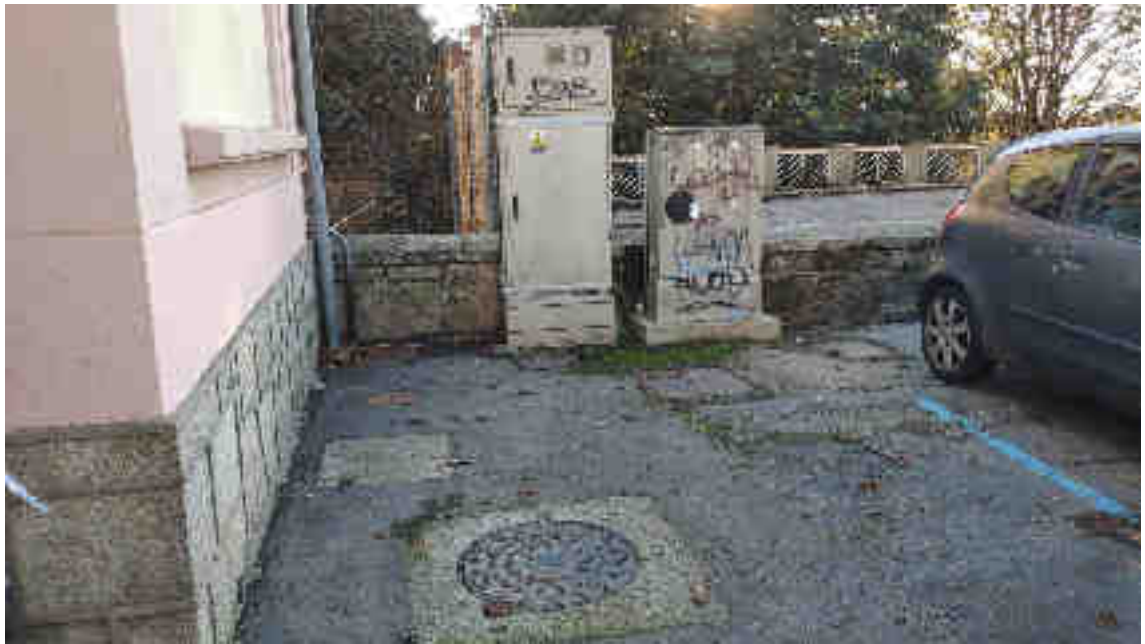
Ilustración 18 Último pozo visible da liña de BT de BEGASA na Avda García Portela xunto a varios cadros eléctricos
