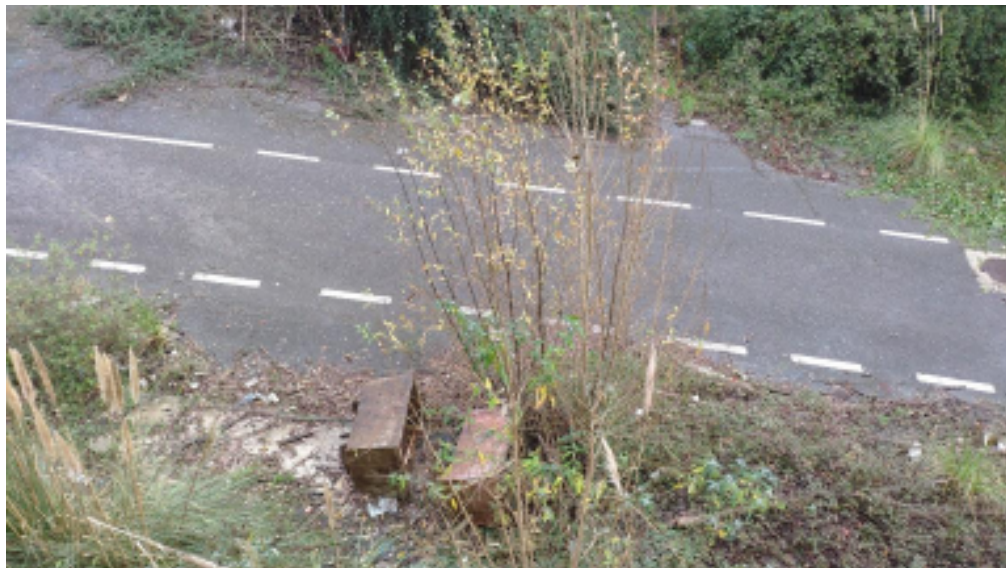
22.Estado actual da rúa Garañón
