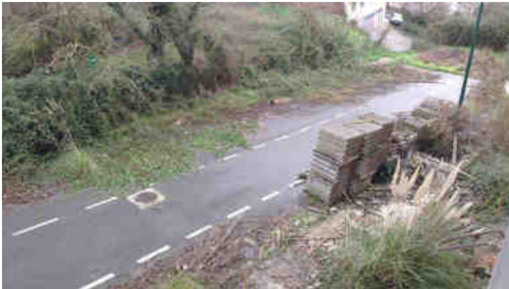
23. Estado actual da rúa Garañón
