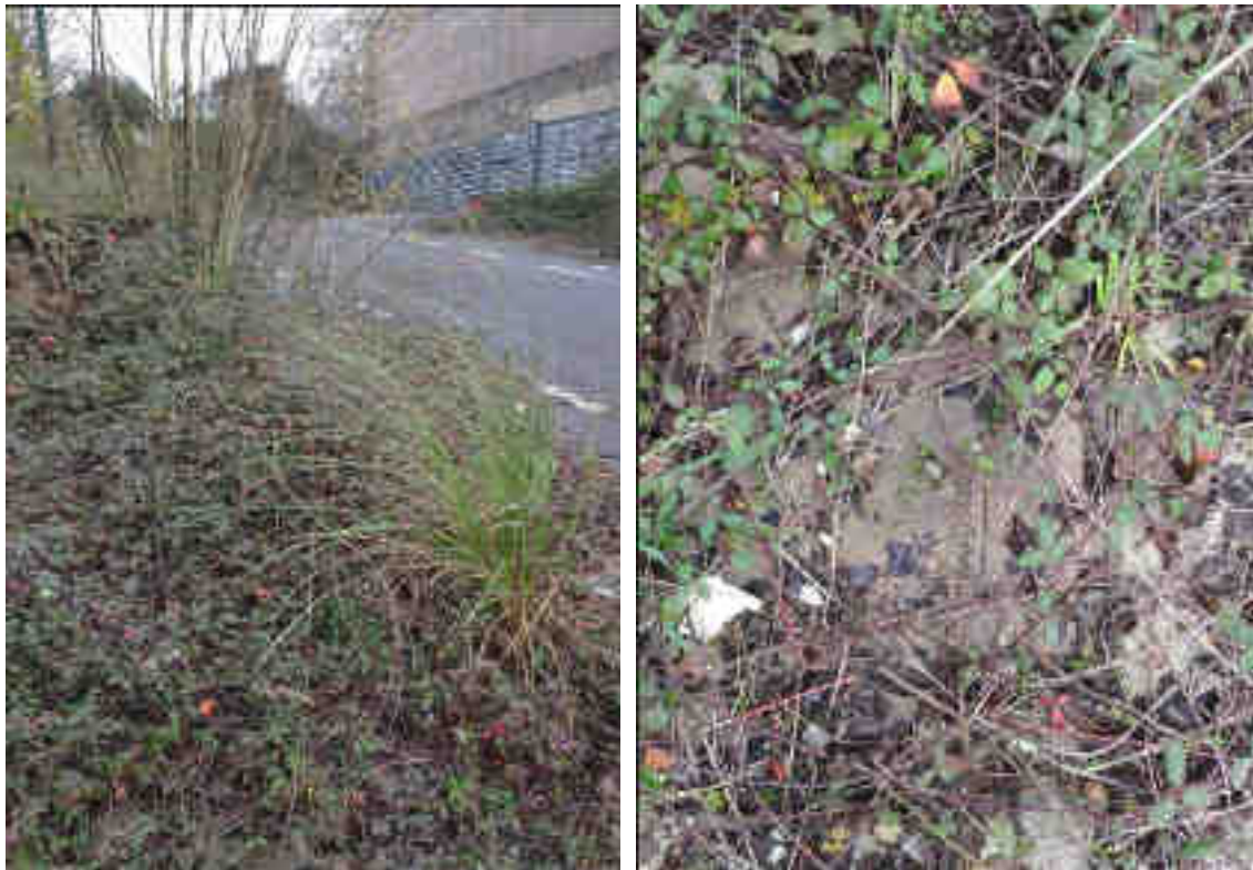
Ilustración 20 Arquetas de Telefónica baixo a maleza nas beirarrúas no tramo novo da rúa Garañón dentro do ámbito
