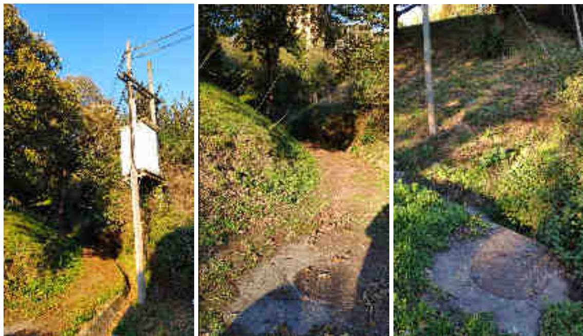
13. Diferentes vistas das dúas liñas de TELEFÓNICA e BEGASA (aérea e soterrada respectivamente) que soben cara a Avda. García Portela
