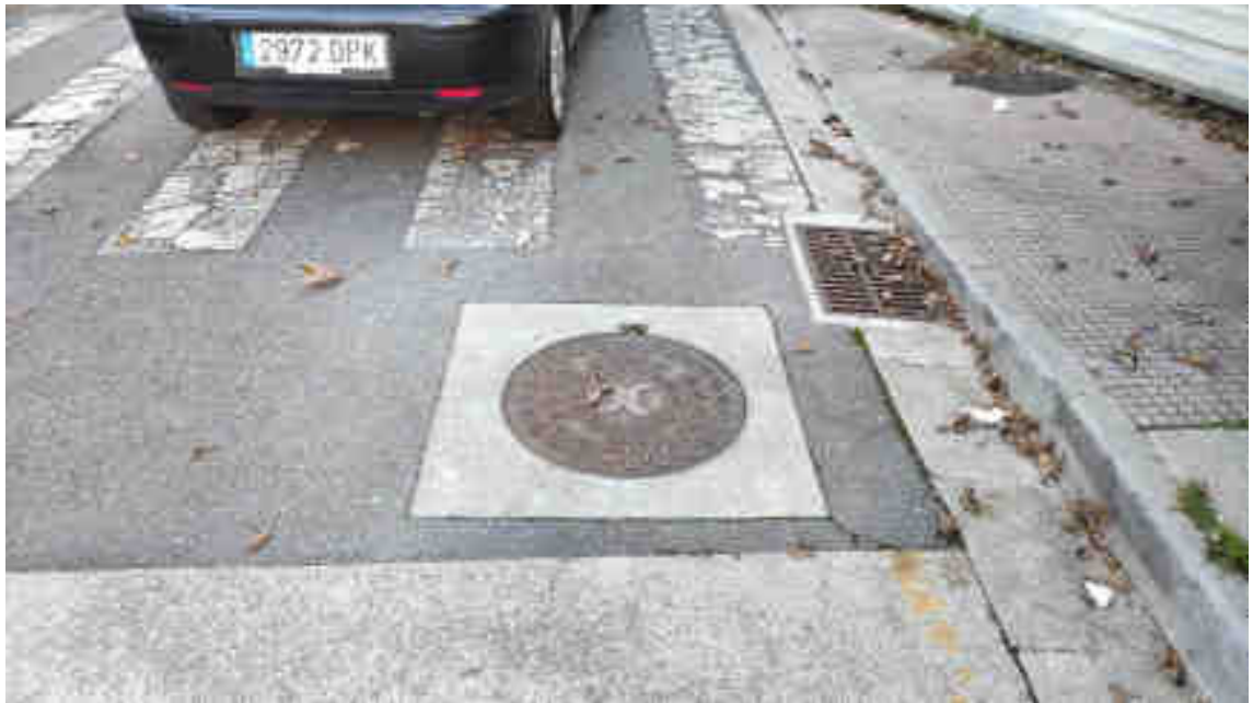
Ilustración 17 Arqueta da liña de BT de BEGASA na rúa Xacobe III de Inglaterra
