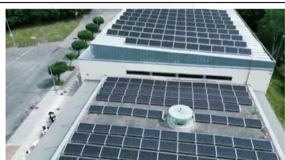
246 paneis solares Sunpower Maxeon 3 de 400W, 98.400 Wp totais
